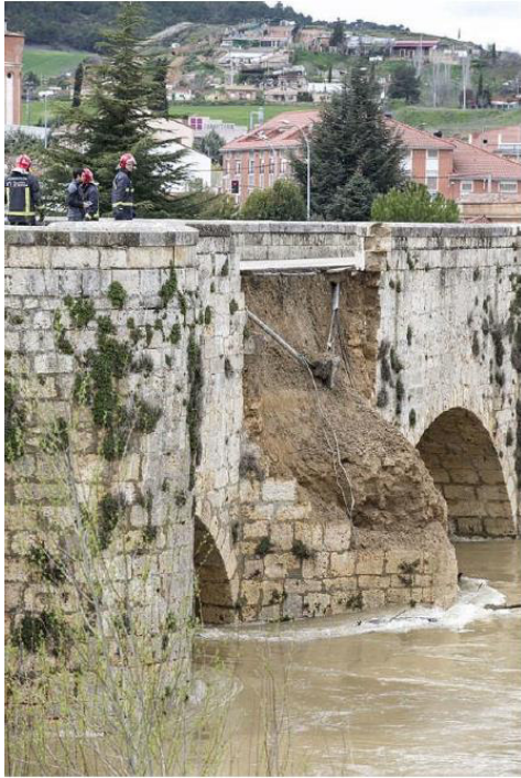
Figura 56. Desprendimiento de tímpano en Villamuriel de Cerrato
